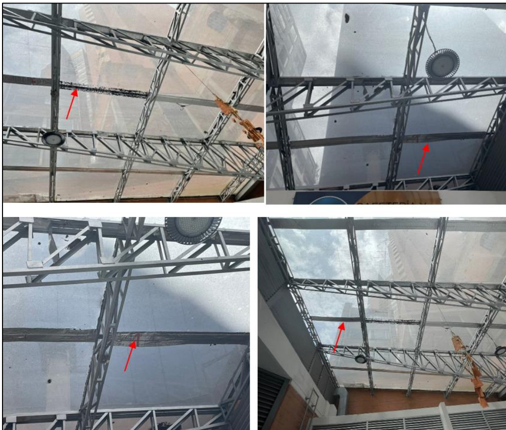
Imagen 7. Ítem NP-4 Suministro e instalación de cinta bituminosa autoadhesiva impermeabilizante tipo sika multiseal o similar de 15 cm
