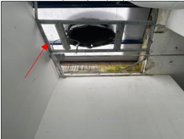
Imagen 5. ítem 8.2.1 Cielo raso plano dry wall (incluye pintura a 3 manos por 1 cara)
