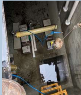
Mantenimiento de equipos de bombeo PDM Concordia
