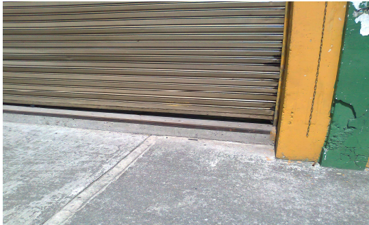
Rejas de ingreso dañado iluminación
