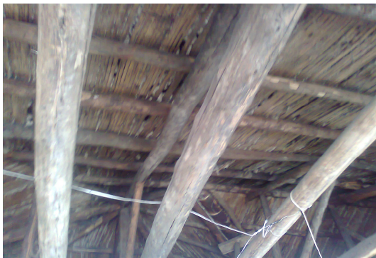
Malas condiciones del techo módulos
