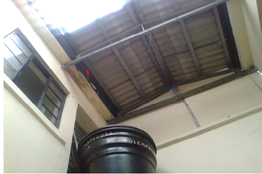
Estado de los techos y de la
