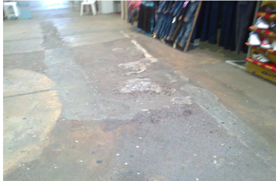
Deterioro de los pisos
